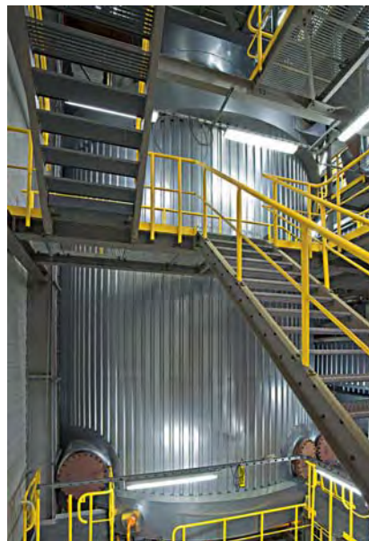
Wärmetauscherkopf im BFG-System
