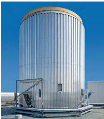
Rauchgaskamin auf dem Kesselhausdach
